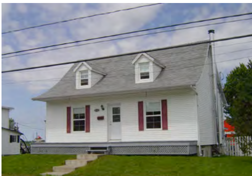
Un édifice de Louiseville revêtu de vinyle mais dépourvu de garnitures de rive (planches cornières ou chambranles). DSC01685.jpg
